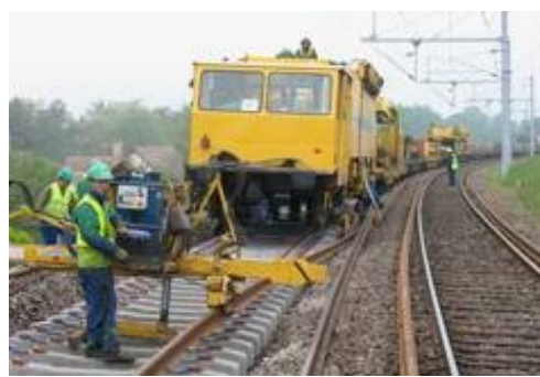
Longs rails soudés sur traverses béton
