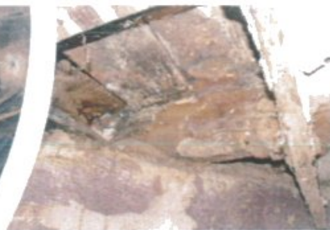
Humidité et condensation sur un solivage de cave
