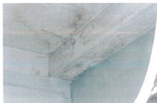
Traces d'infiltrations sur un plafond comportant des bois coffrés
