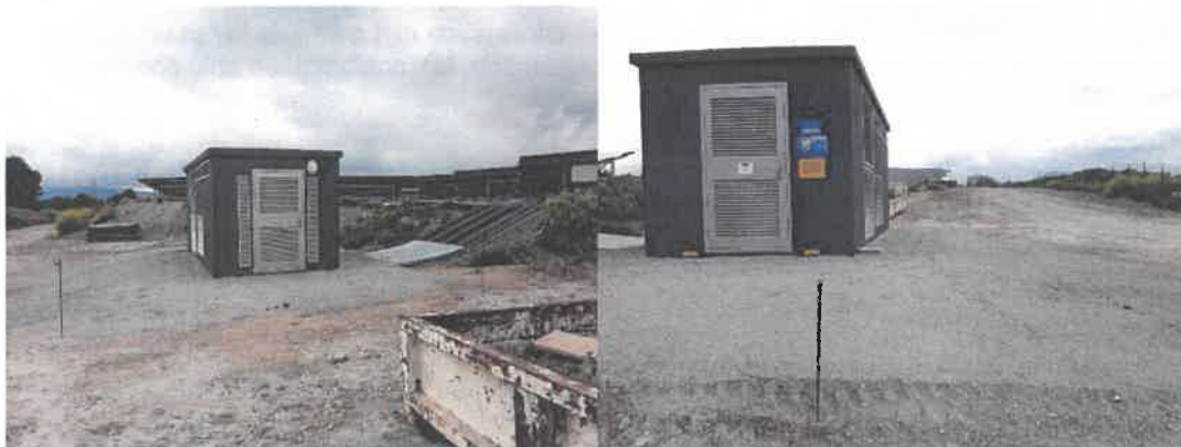
Figure 24 : Exemple de poste de transformation
