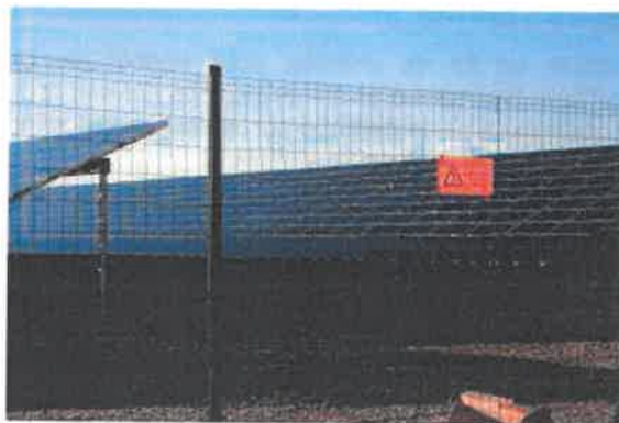
Figure 34 : Clôture grillagée autour d'une centrale solaire photovoltaïque
