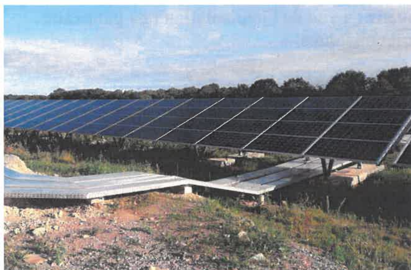
Figure 31: Exemple de chemin de câbles
