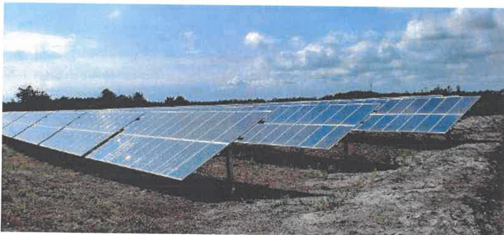
Figure 16 : Exemple de centrale photovoltaïque équipée de panneaux fixes – technologie cristalline (couche épaisse)
