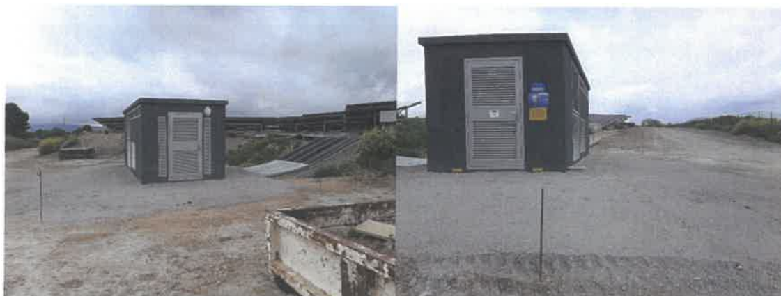
Figure 23 : Exemple de poste de transformation
