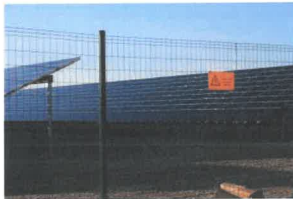
Figure 33 : Clôture grillagée autour d'une centrale solaire photovoltaïque
