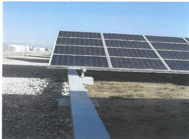
Figure 26 : Exemple d'un chemin de câbles
