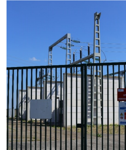
Le poste « source » de Châteaudun est à 2,84 km. (crédit photo Enviroscop)
