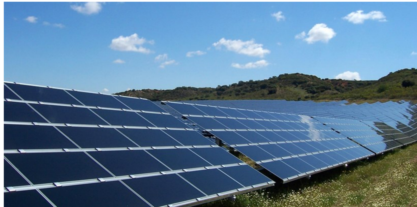
Parc photovoltaïque EDF Renewables de Narbonne
