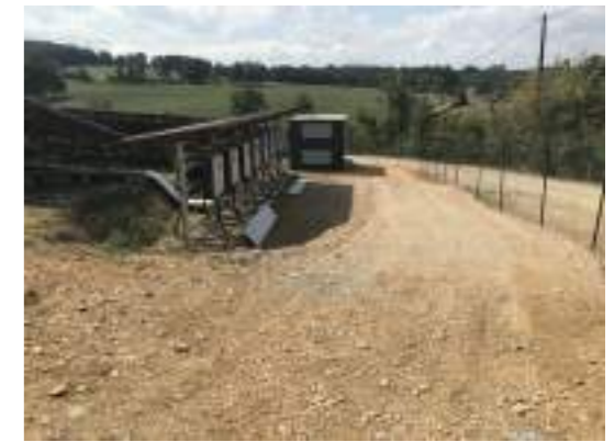
Photo illustration des locaux onduleurs
