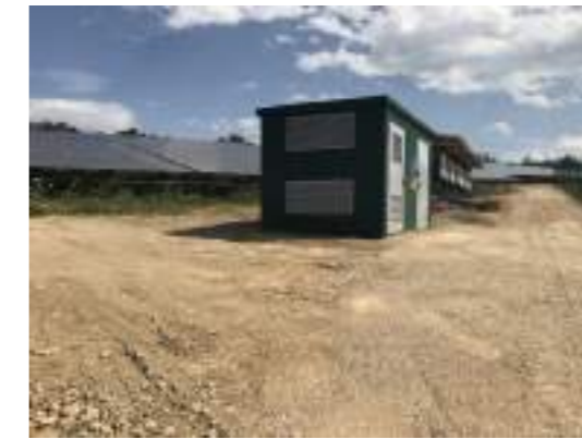
Photo illustration du poste de transformation
