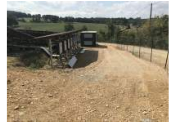
Photo illustration des locaux onduleurs
