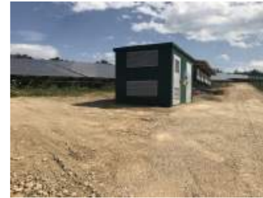
Photo illustration du poste de transformation
