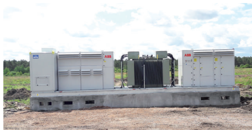
Exemple de poste de transformation «Outdoor»
