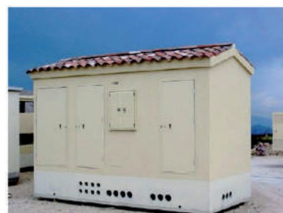
Exemple de poste de livraison
