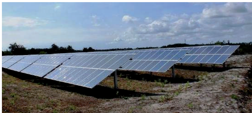
Exemple de centrale photovoltaïque équipée de panneaux fixes – technologie cristalline (couche épaisse)
