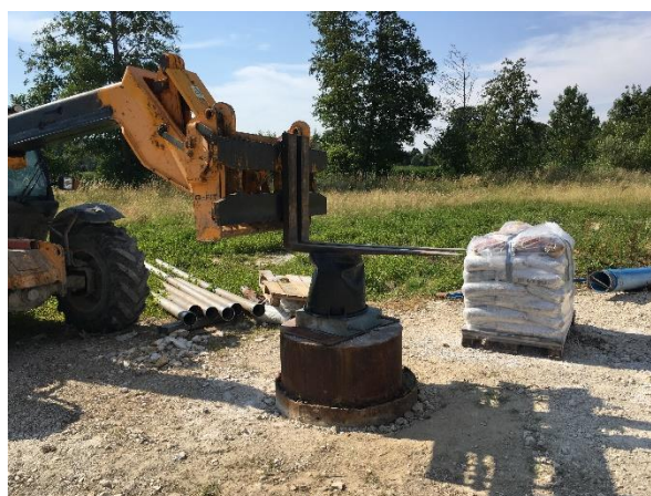
d) Vue du forage F1 en cours d'équipement (l'Eure coule au niveau des arbres visibles au fond)
