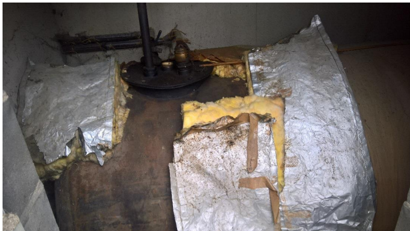
Cuve à fioul
