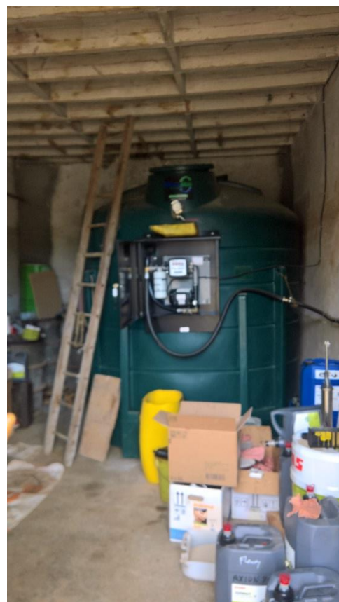
Cuve à carburant
