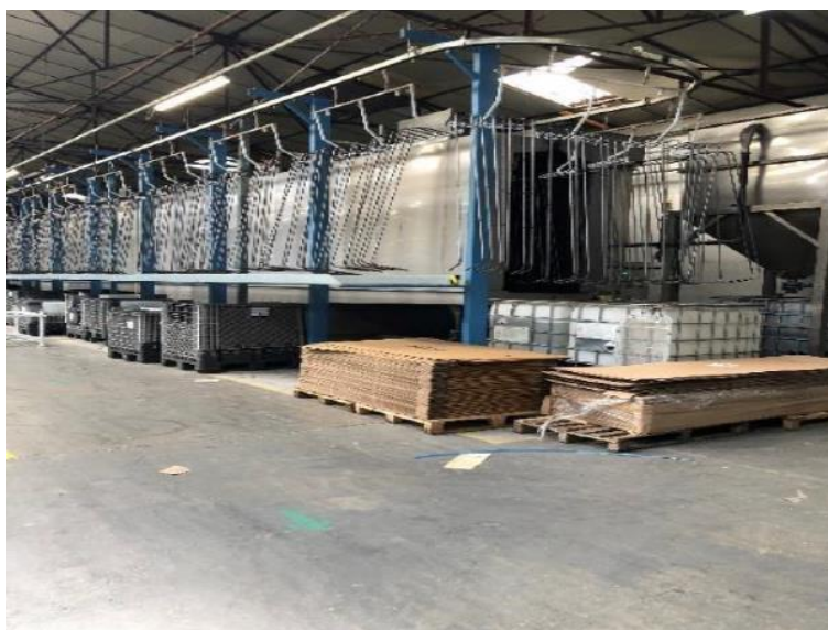
Tunnel de dégraissage phosphatant (source = extrait étude GAIA Conseil)
