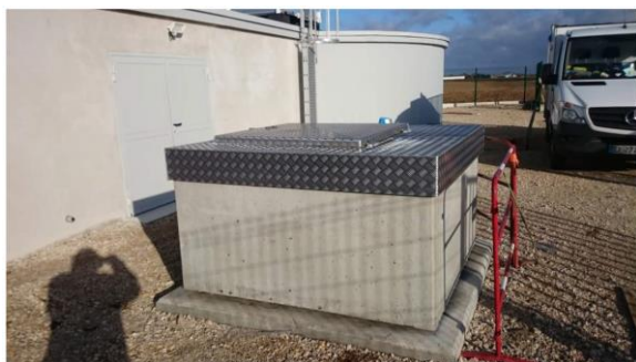
Figure 7. Installations de surface F1
