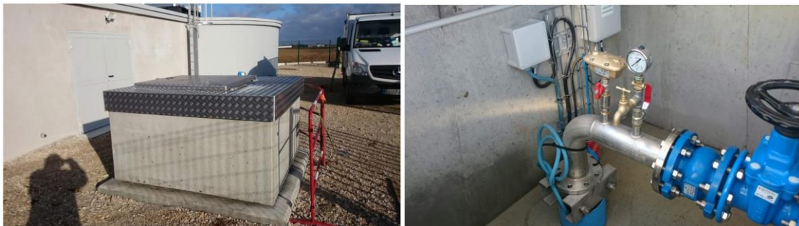
Figure 15. Installations de surface F1
