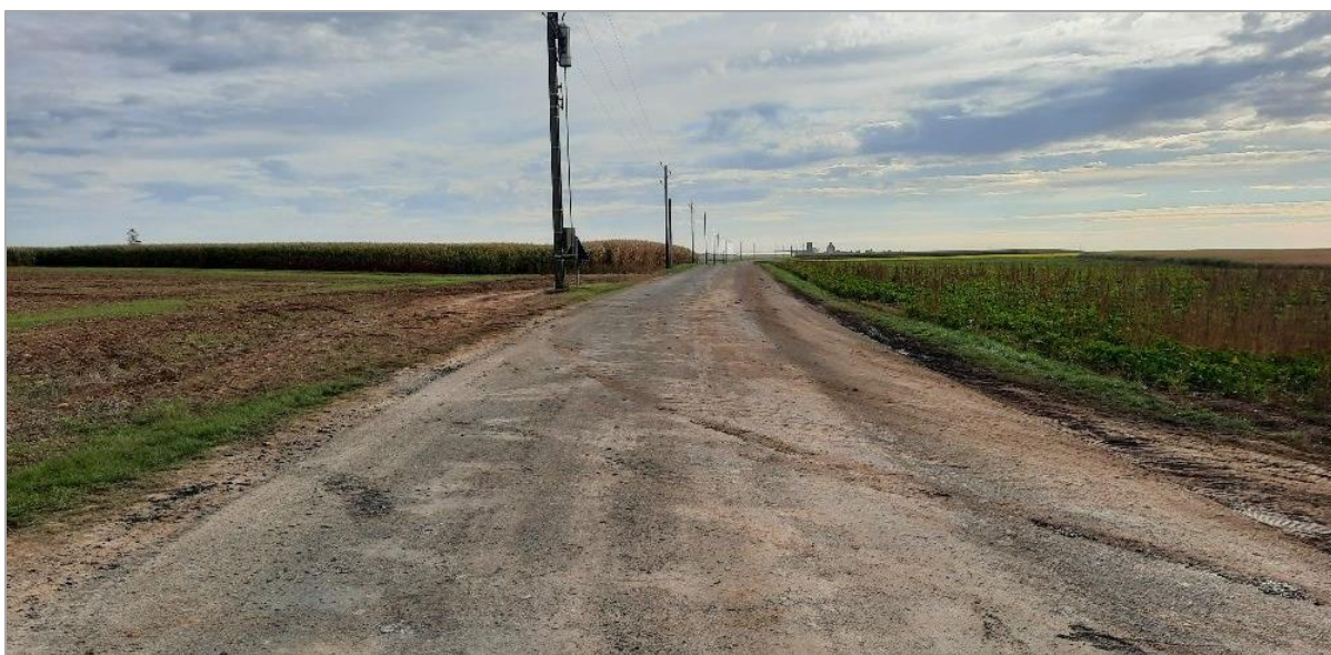
Photographie 15 : Prise de vue n°31 de la sortie de bourg de Guillonville, sur la rue du Moulin, en direction de Gommiers
