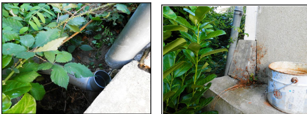
Figure 36: Gouttière qui rejette les eaux pluviales dans la falaise au n° 5, rue de la Mail
