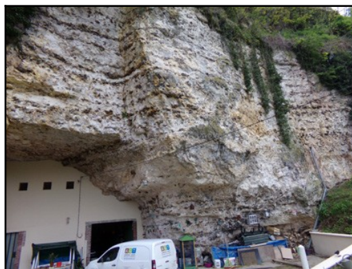
Figure 48: État de la falaise à l'entrée de la cavité
