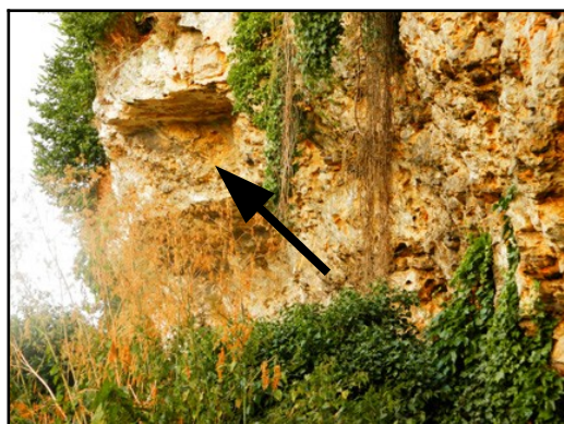
Figure 29: Cicatrice d'un ancien éboulement d'éboulement sur cette zone.
