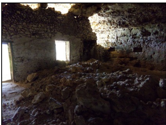
Figure 47: Chute de toit à l'intérieur de la cavité
