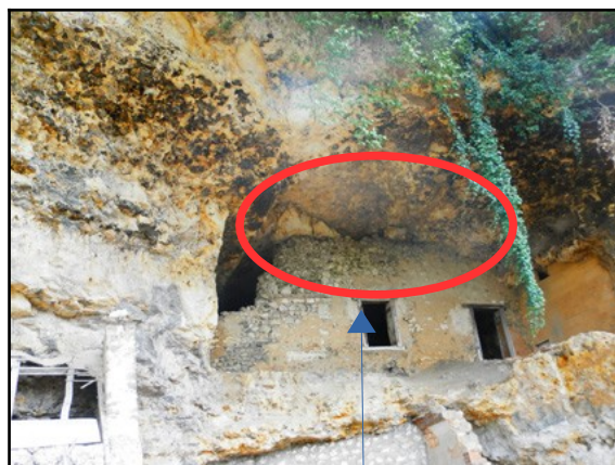
Figure 45: Blocs en équilibre au niveau du mur de la maison troglodyte
