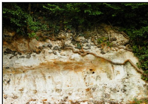
Figure 24: État de la falaise au-dessus du garage
