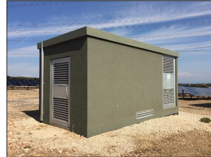
Exemple de poste de conversion « indoor »
