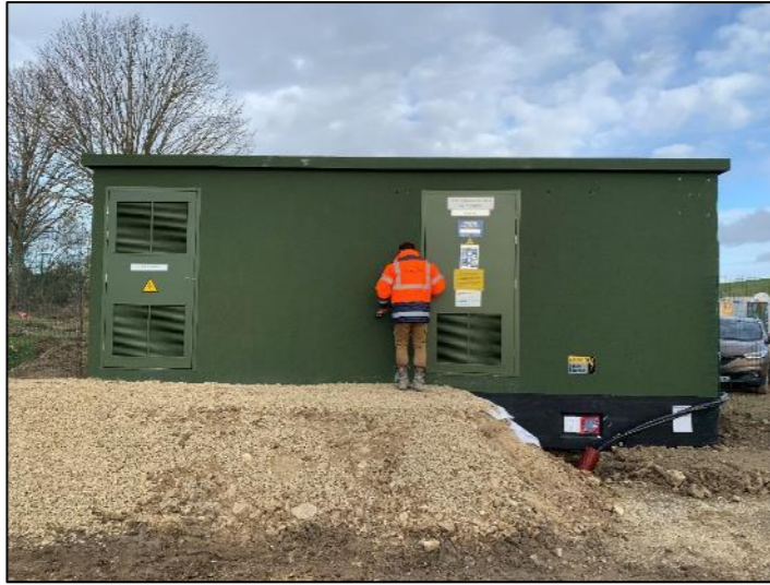
Exemple de poste de livraison
