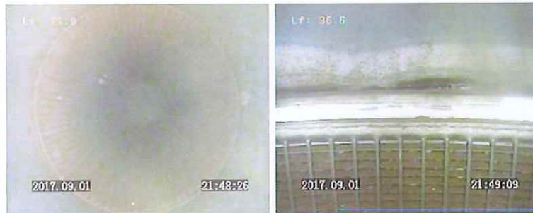
Figure 3 : Entrée dans les crépines
