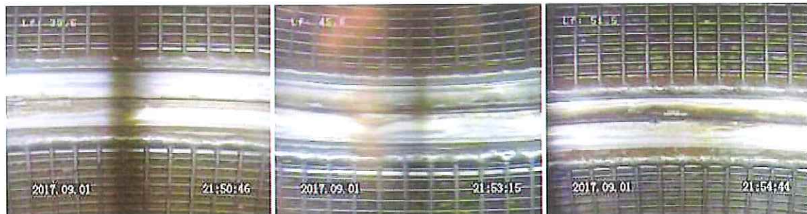
Figure 4 : Joints visibles dans les crépines
