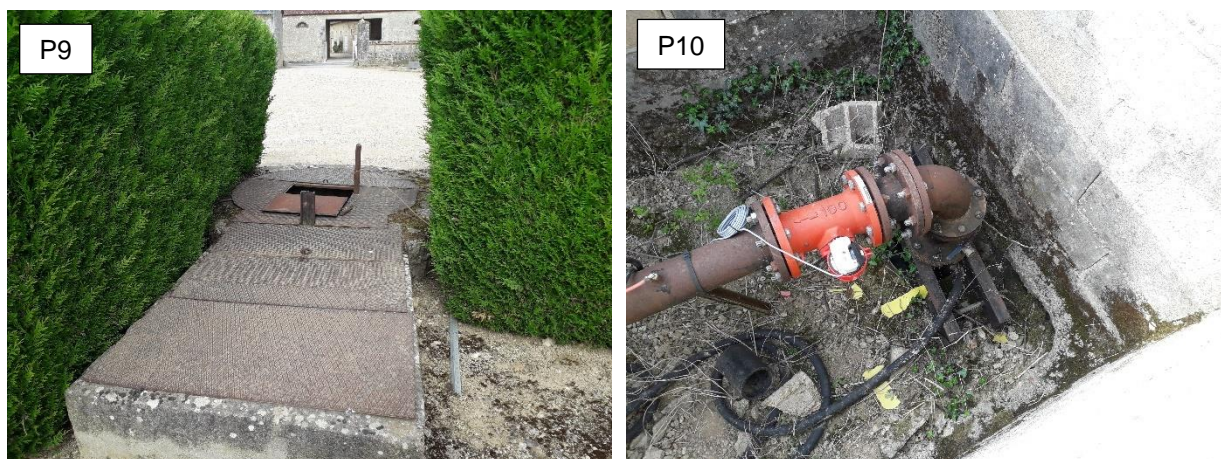
Figure 2-8 : Photographies des 2 forages d'irrigation mesurés hors pompage (CPGF, mai 2022)
