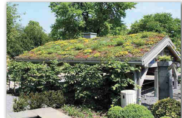
Figure 30 / Toiture végétalisée à 2 pans sous un climat océanique, Grugapark près d'Essen en Allemagne.
